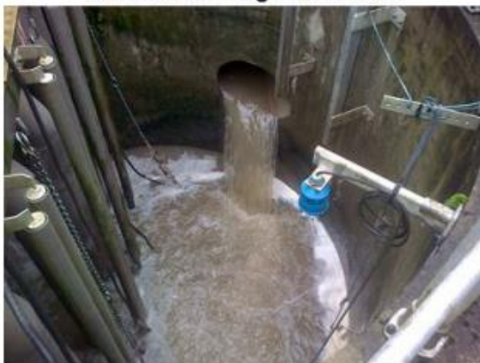
Arrivées des effluents
