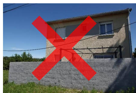
Mur en moellons mal enduits
