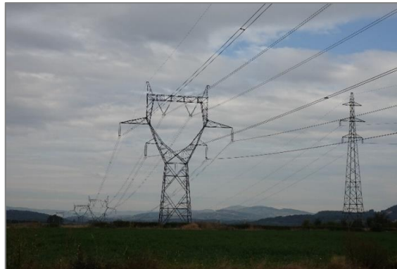
Couloir de lignes électriques
