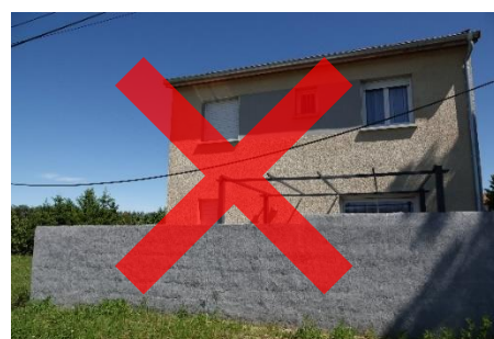
Mur en moellons mal enduits
