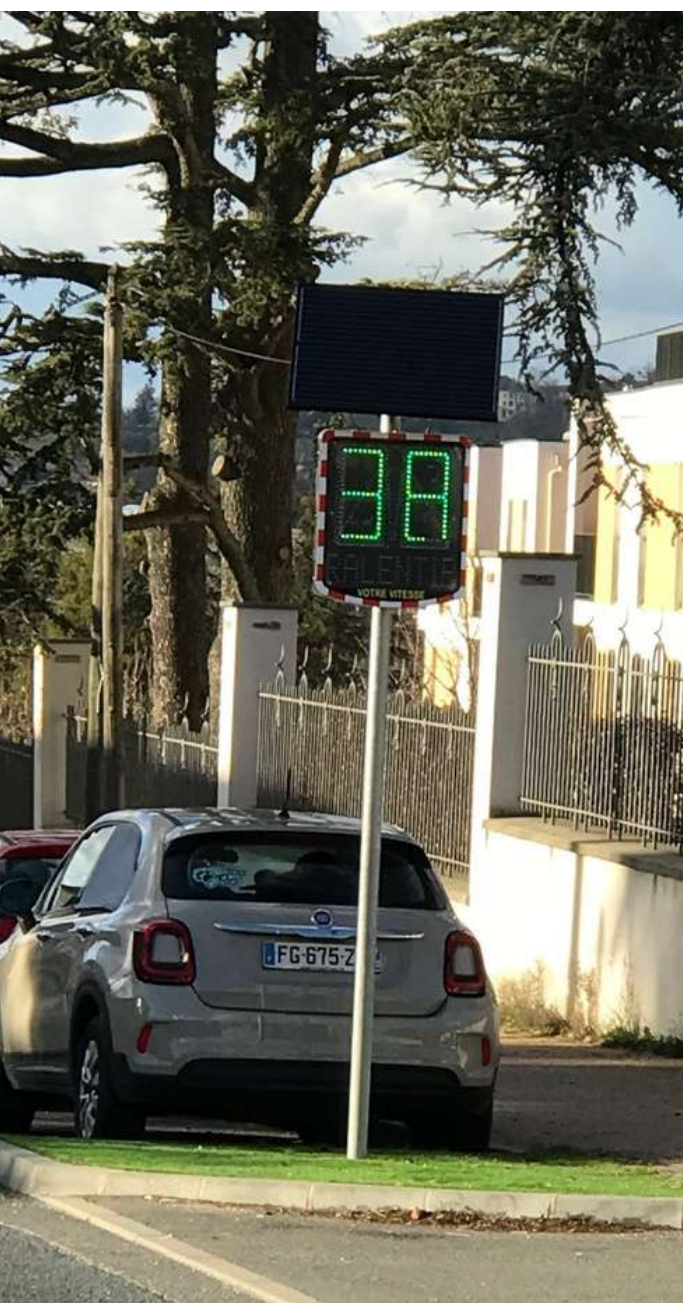
Installation de radars pédagogiques
